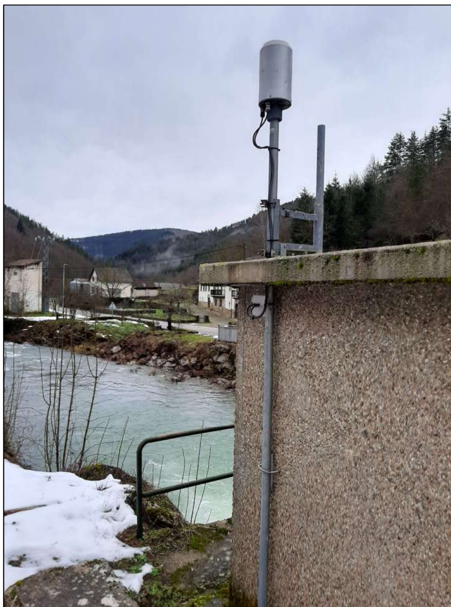
Figura 13 Imagen del pluviómetro instalado por la Confederación Hidrográfica del Ebro sobre la caseta de su estación de aforo del río Anduña en Izalzu.
